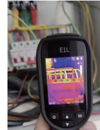
Elektromos rendszer ellenőrzése
